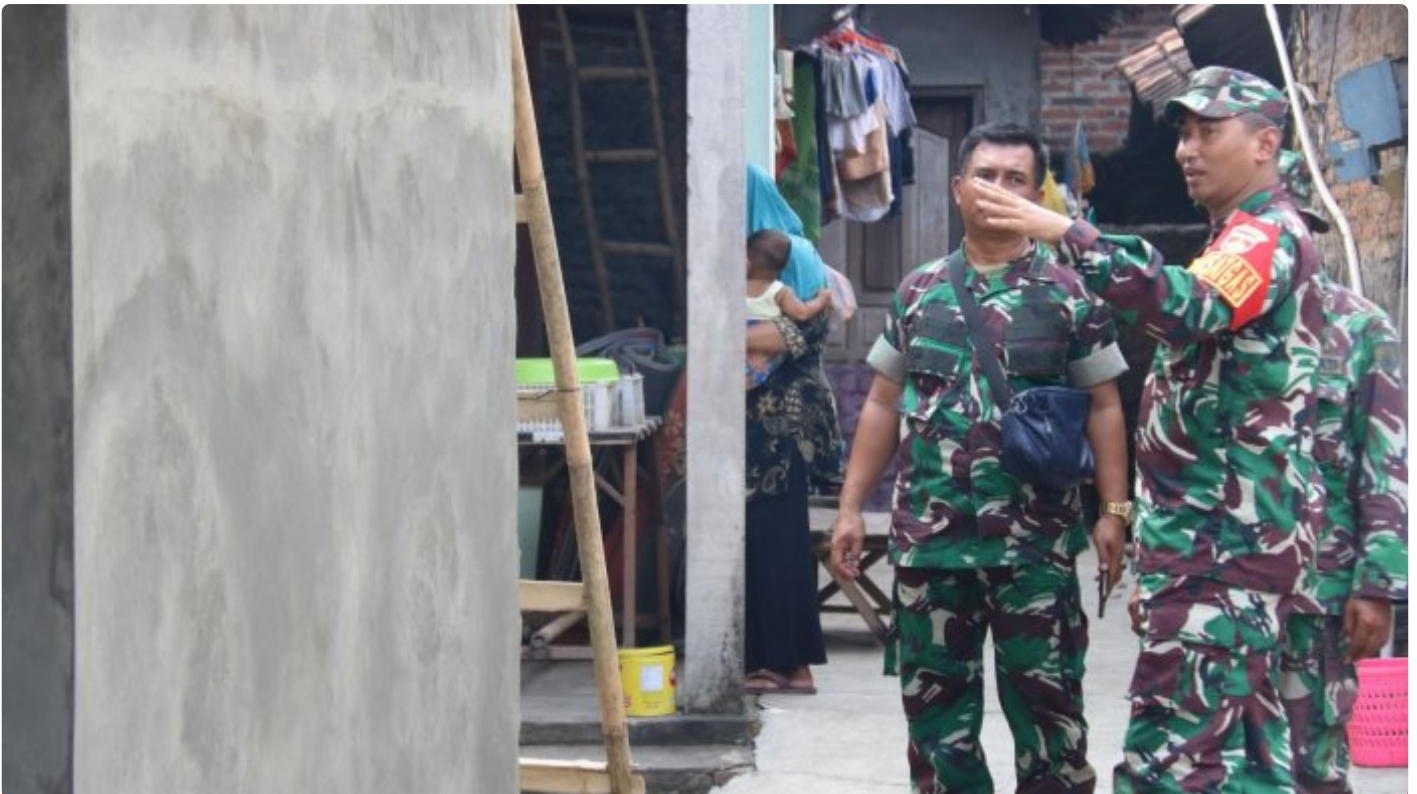
(Foto istimewa ) dansargas tmmd tinjau lokasi RTLH
